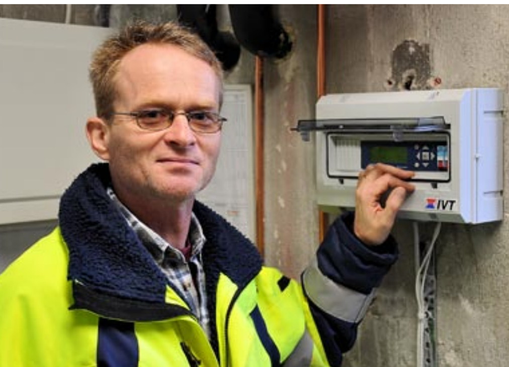
Mats Martinsson, kyrkovaktmästaren i Härlunda, visar värmepumpens styrpanel som gör det möjligt att enkelt programmera in både fasta och tillfälliga aktiviteter i kyrkan för korrekt styrning av kyrkorummets temperatur.
